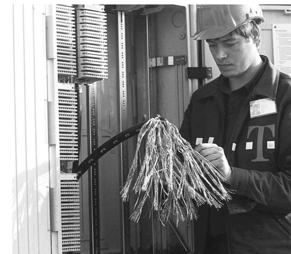
Beim Aufbau des hochmodernen Netzes sind umfangreiche Arbeiten an der Netzinfrastruktur erforderlich.
